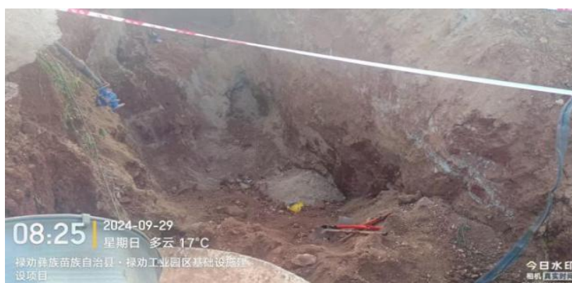
图 3 事故现场照片
