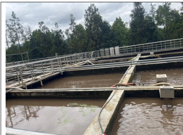
A 2 O 生化处理池
